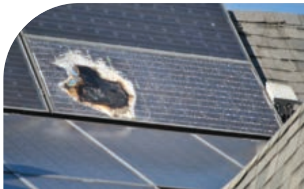
Slika 13: Oštećen fotonaponski panel
