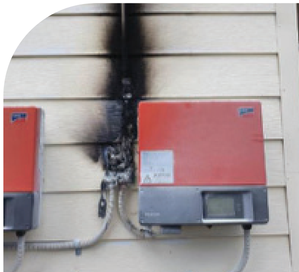
Slika 15: Oštećen inverter usled pregrevanja
