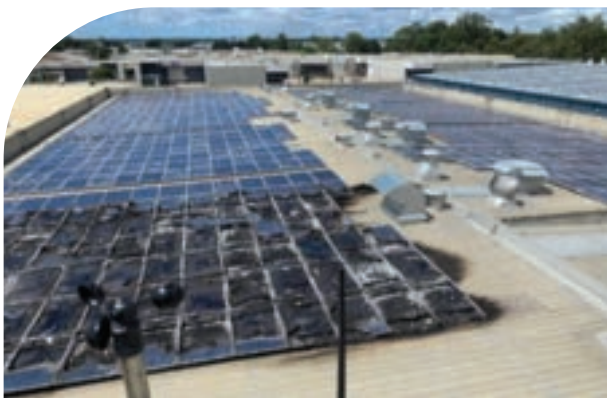
Slika 12: Oštećen fotonaponski panel
