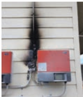
Slika 14: Oštećen inverter usled pregrevanja
