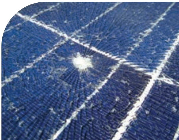
Slika 11: Oštećen fotonaponski panel
