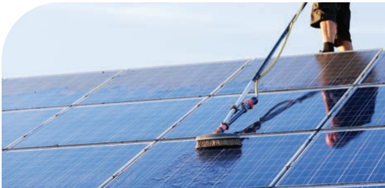
Slika 13: Čišćenje fotonaponskih panela
