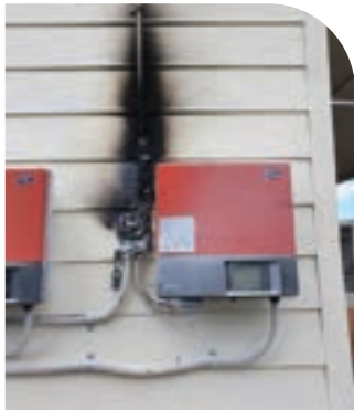
Slika 14: Oštećen inverter usled pregrevanja
