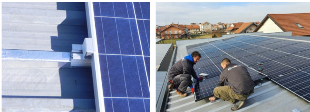
Slika 1.3 FN paneli na kosom krovu pokrivenim trapezastim limom
