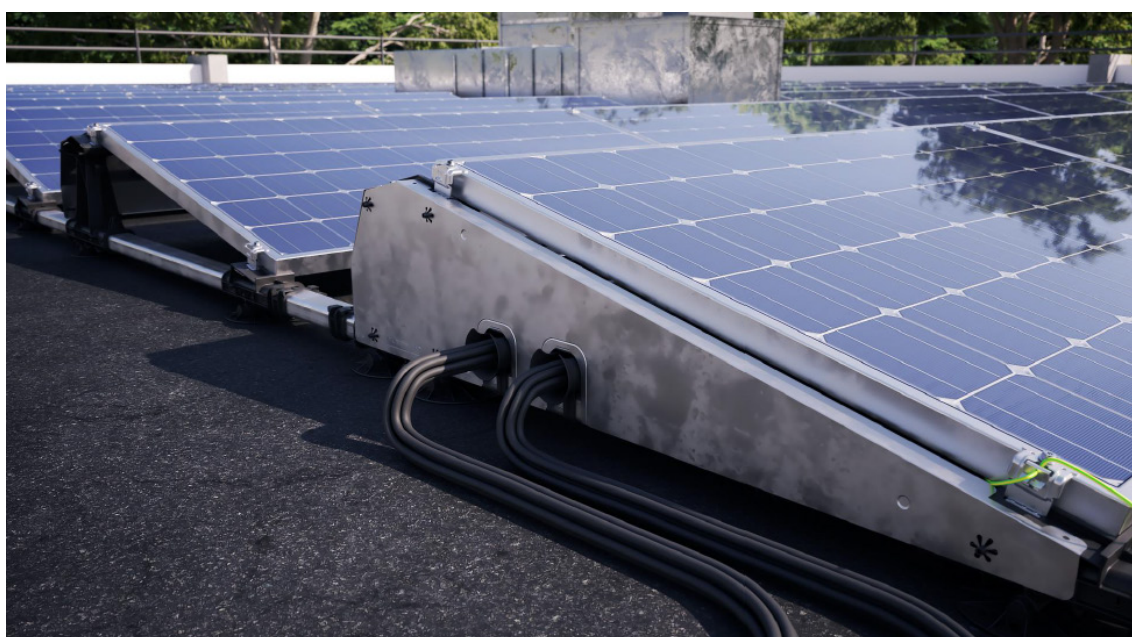
Slika 1.10 Izgled mehaničkog sistema sa postavljenim fotonaponskim panelima na ravnom krovu.
