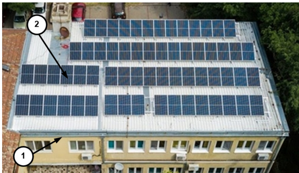
Slika 1.3 FN elektrana na krovu stambene zajednice: 1-objekat, 2-fotonaponski paneli
