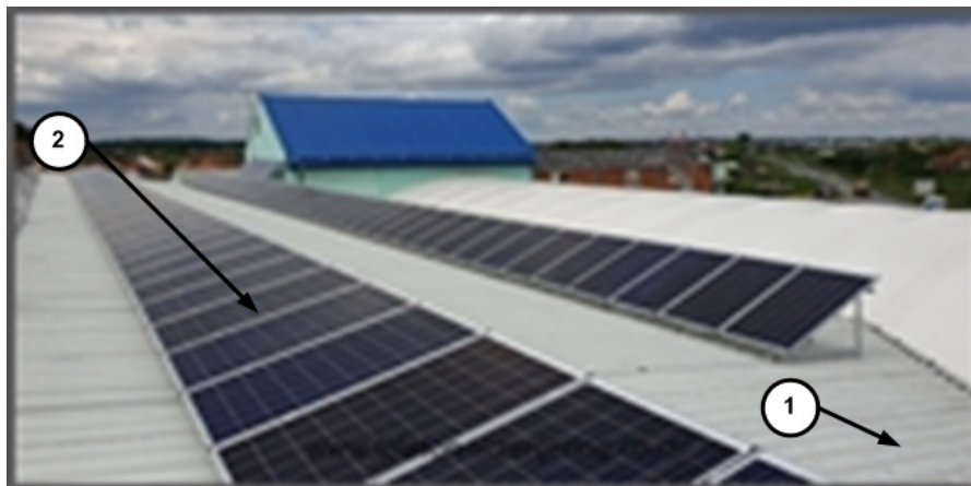
Slika 1.2 FN elektrana na krovu proizvodnog objekta: 1-krov objekta, 2-fotonaponski paneli.
