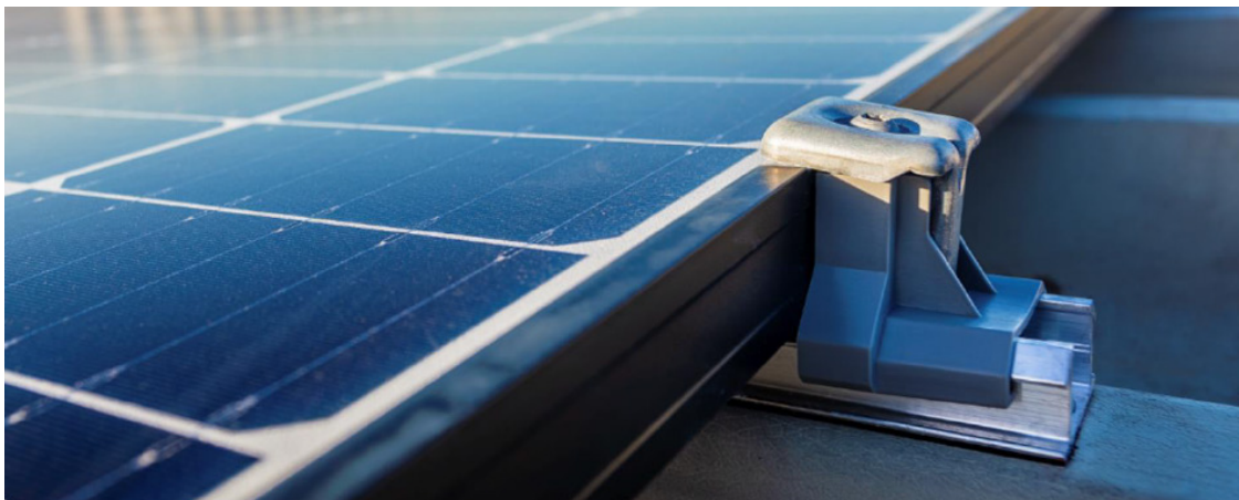
Slika 1.19 Prikaz mehaničkog nosača sa postavljenim fotonaponskim panelima na kosu krovnu konstrukciju ot trapeznog čeličnog lima.
