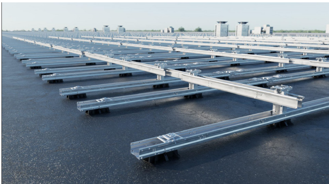
Slika 1.10 Izgled mehaničkih nosača koji su postavljeni na ravan krov objekta.
