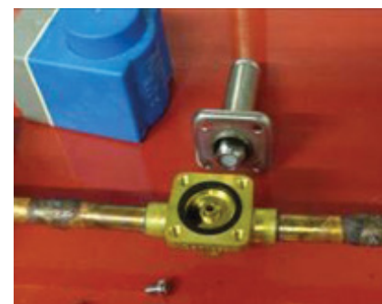
Slika 112: Curenje na zaptivnim elementima komponenti sistema
