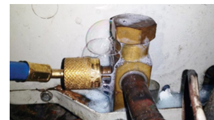
Slika 102: Curenje na servisnom igličastom ventilu
