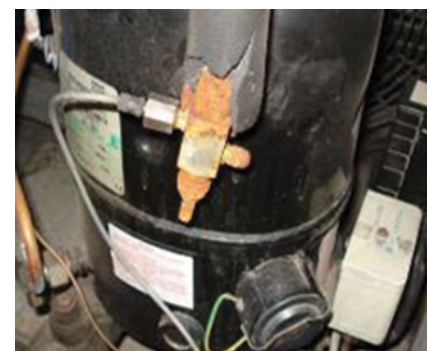
Slika 101: Korodirani ventil na usisu kompresora
